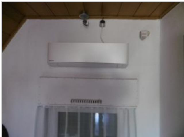
De airco-unit op de eerste verdieping.
